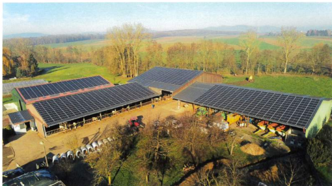
Les grosses puissances ont de plus en plus la cote sur les toits des bâtiments agricoles. Ici, une installation de 250 kWc installée en 2020 à Balschwiller, dans le Haut-Rhin. © ECE
