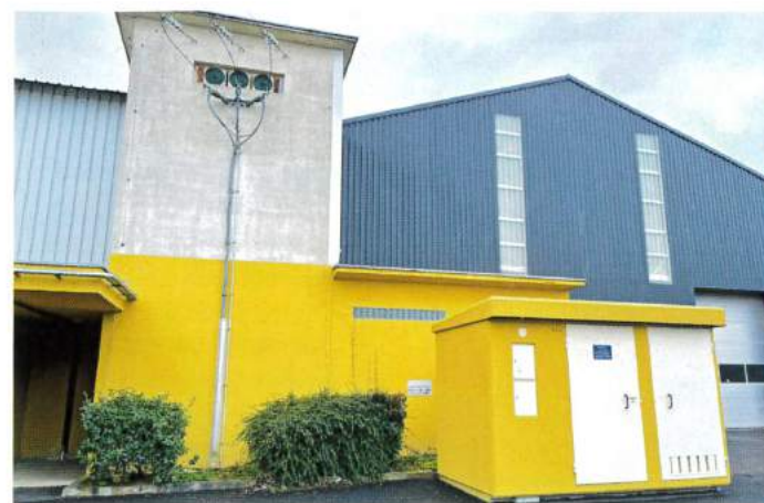
Au-delà d'un certain seuil de puissance, l'installation de poste de transformation 400/20 000 volts est à la charge du producteur d'énergie.
